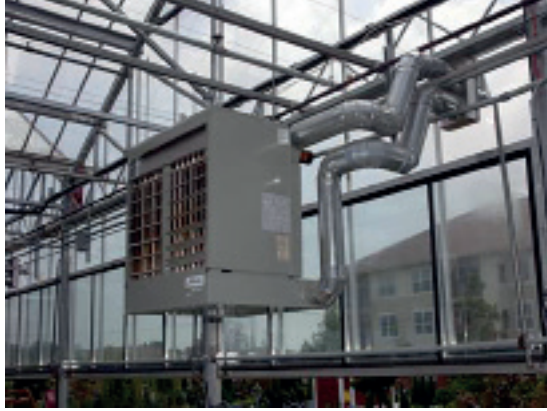
Görsel 2.71: Elektrikle ısıtma sistemi
