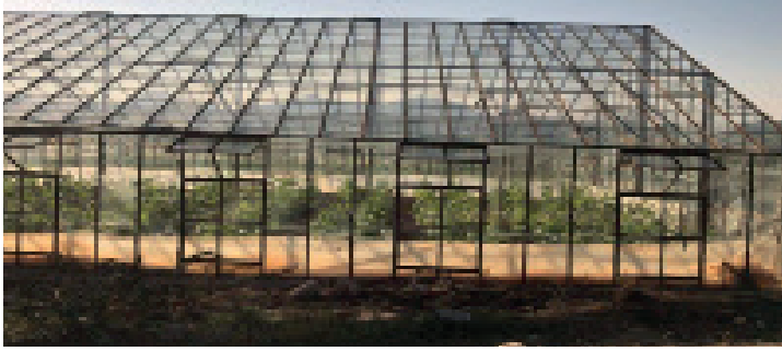
Görsel 2.80: Doğal havalandırma pencereleri
