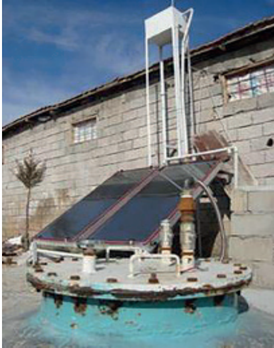
Görsel 2.58: Güneş kolektörü
