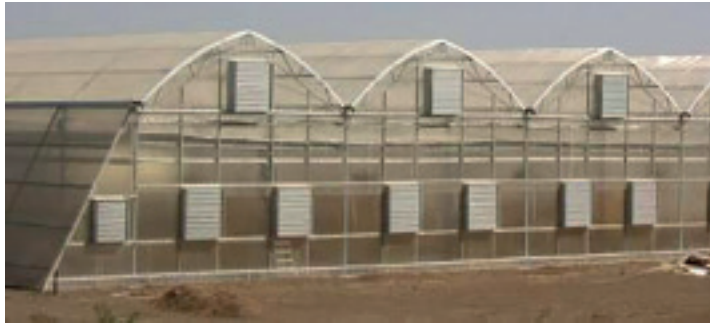
Görsel 2.81: Mekanik (zorunlu) havalandırma
