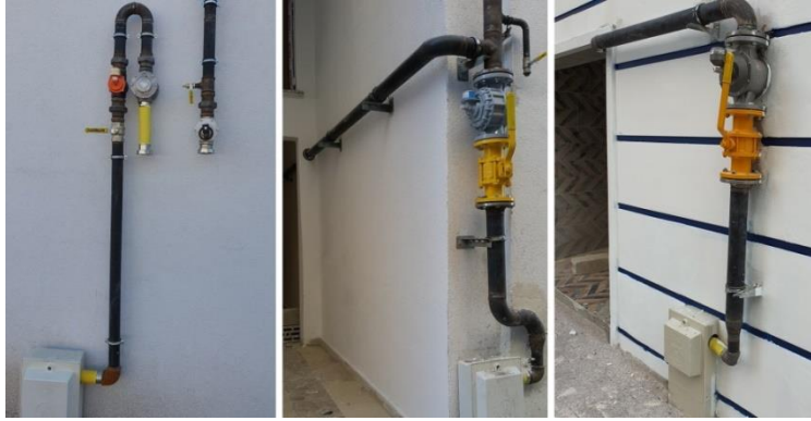
Görsel 3.2: Bina bağlantı hattı
