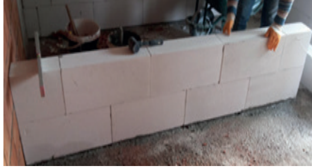
Resim 19.13: Bloklarda derz kaydırılması
