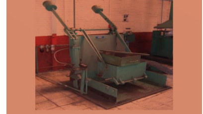
Görsel 2.2: Kömür düşürme bunkerı
