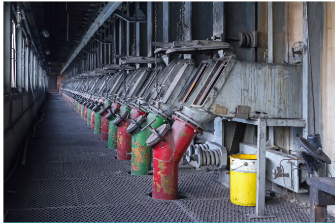
Görsel 3.13: Kok bataryası üzerindeki gaz dağıtım kanalındaki baca gazı kutusu
