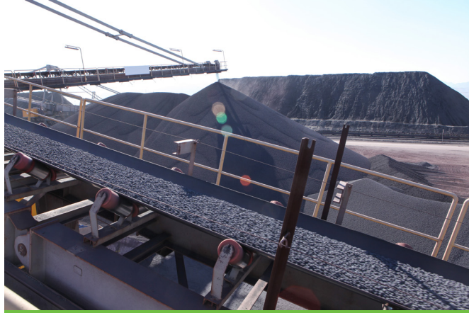
Görsel 1.11: Konveyör taşıyıcı bant sistemi
