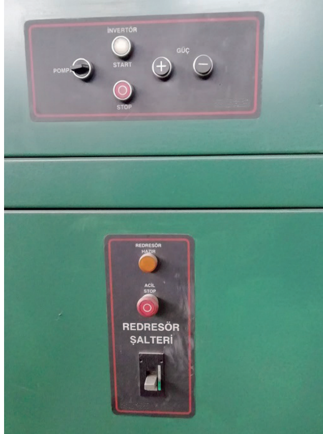
Görsel 8.5: Invertör start-stop düğmesi
