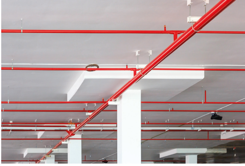
Görsel 5.12: Sprinkler sistemi
