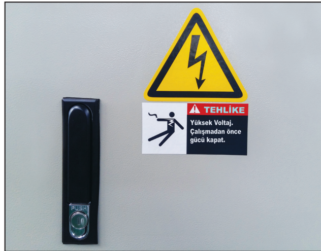
Görsel 1.1: Elektrik panosu uyarı levhası
