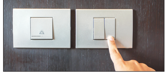
Görsel 2.56: Elektrik anahtarları
