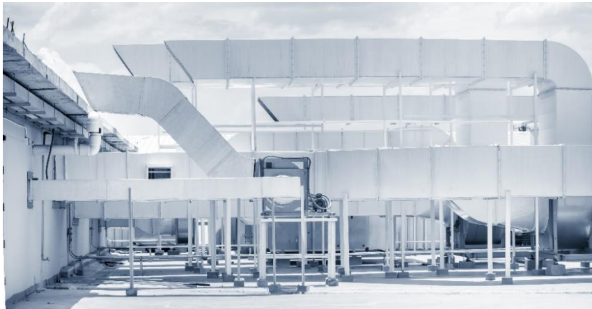
Görsel 2.15: Gıda üretim tesislerinde havalandırma sistemi önemlidir.
