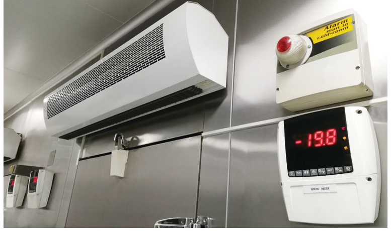
Görsel 1.27: Soğuk depo kontrol sistemleri
