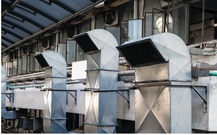
Görsel 1.25: Havalandırma sistemleri
