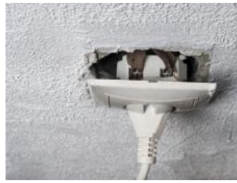
Resim 4.4: Arızalı prizler ve açık elektrik kabloları
