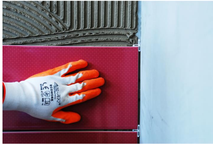
Resim 6.58: Bitişik duvar ve kaplama arası derz boşluğu
